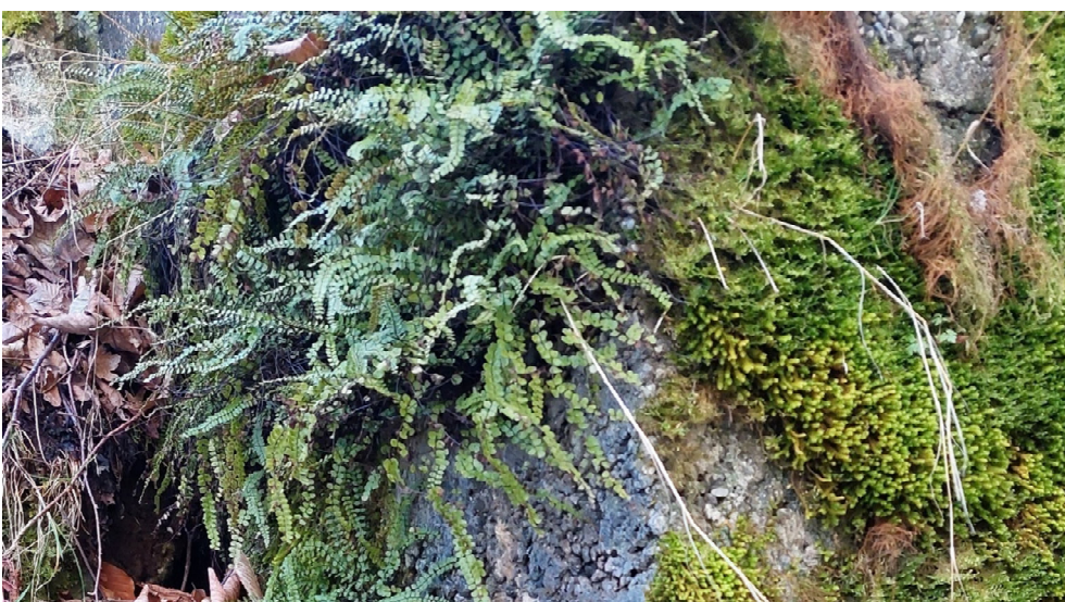
Abb. 13: Farne in Böschung zur B17 hoch auf „künstlichem“ Fels (Beton).
